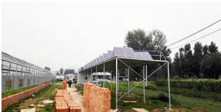
木林30KW光伏农业大棚
