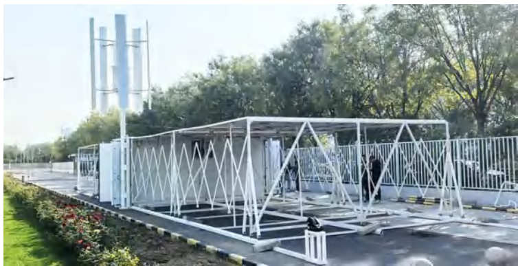
北科院风光互补移动能源供电箱
